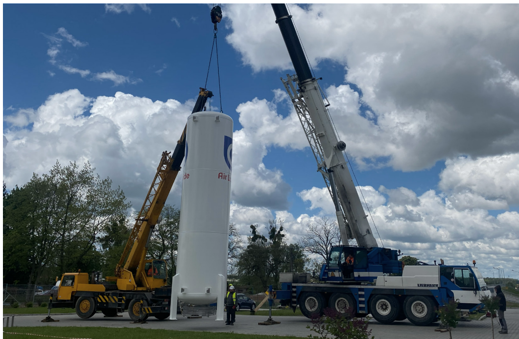
Fot.11. Wielkopojemnościowa infrastruktura do magazynowania ciekłego azotu, pomyślnie zintegrowana i uruchomiona w zakładzie produkcyjnym w Żałuskach.
